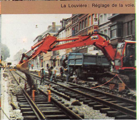
La Louvière : Damage de la voie.
